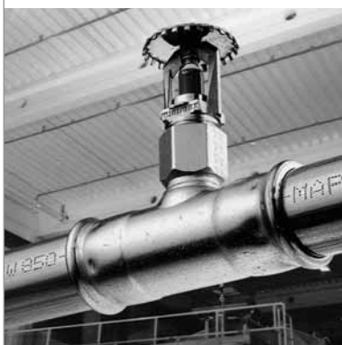
Figur 3: T-stykke (rustfrit stål) med sprinklerhoved
